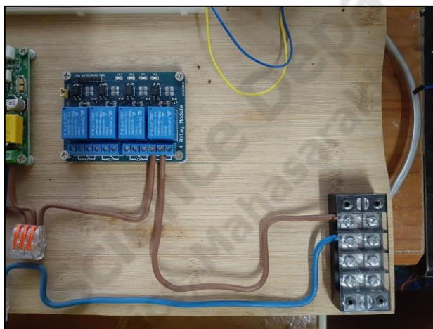
ภาพประกอบที่ 3.17 การต่อสายไฟเข้า Relay
