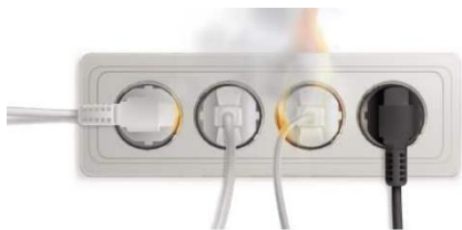
รูปที่ 2 การเกิดอัคคีภัยจากกระแสไฟฟ้าลัดวงจร
